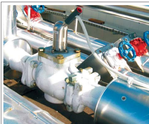
Rys. 4. Zawór silnikowy hermetyczny typu HMMV-100 firmy HANSEN podczas pracy (na pierwszym planie) w amoniakalnej instalacji chłodniczej t 0 = -10°C. Precyzyjnie reguluje ciśnienie parowania. Zawór zamontowany na zewnątrz, na dachu.
