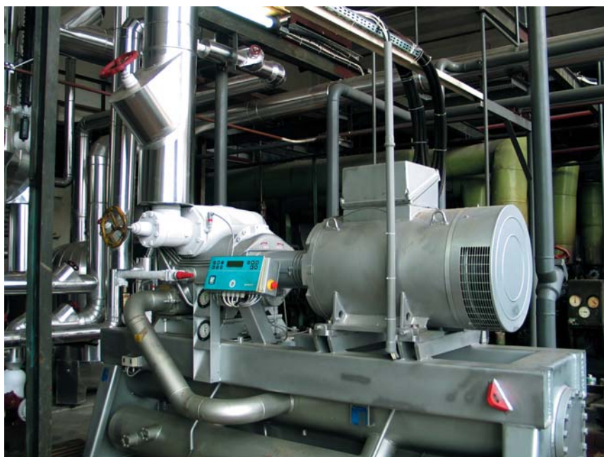
Maszynownia - sprężarka SABROE SAB 202 LF
