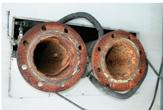
Rys.4. Wnętrze zanieczyszczonego skraplacza płaszczowo-rurowego [14]
