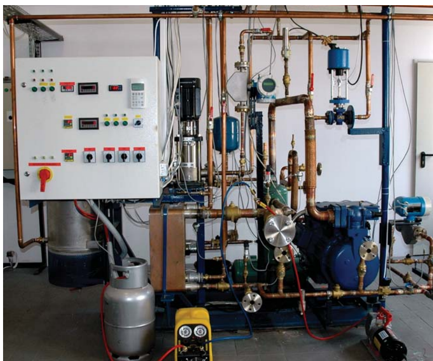
Fot.2. Badawcza instalacja chłodnicza pracująca z czynnikiem R 507
