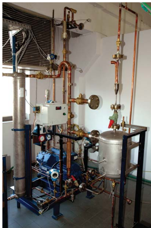
Rys. 3. Badawcza instalacja chłodnicza pracująca z izobutanem, przystosowana do badań strumienic dwufazowych
