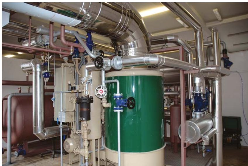
Fot. 4. Wytwornica pary firmy Clayton zamontowana w Laboratorium Energetyki Ciepłej
