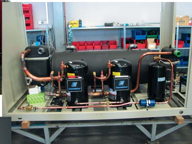
Fot. 5. Agregat do chłodzenia cieczy w końcowej fazie montażu
