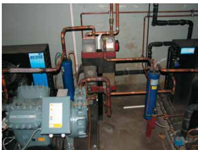
Fot.5 Maszynownia chłodnicza wyposażona w trzy agregaty skraplające z węzłem odzysku ciepła do podgrzania ciepłej wody użytkowej na potrzeby przetwórnictwa
