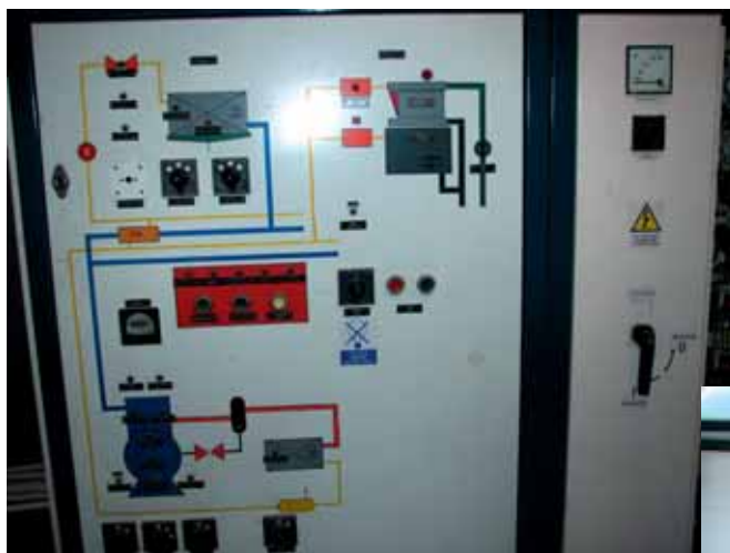
Fot.6 Tradycyjna szafa sterownicza instalacji chłodniczej przetwórci ryb z jakże czytelną identyfikacją poszczególnych jej elementów wraz z wyposażeniem sterująco-zabezpieczającym
