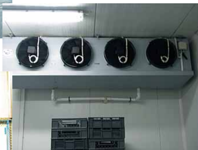
Fot.2 4-wentylatorowa chłodnica powietrza w komorze chłodniczej składowanych pstrągów
