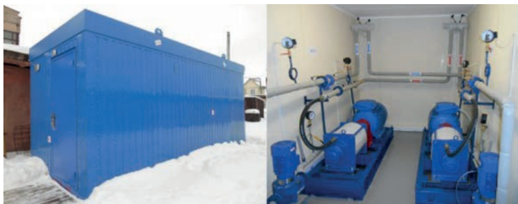
Fot. 8. Dwa generatory ciepła NTG-090 w kontenerze ocieplonym płytą warstwową
