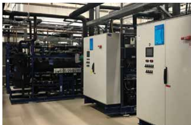
Rys. 1. Stacja energetyczna – maszynownia chłodnicza: boosterowe zespoły sprężarkowe A&B z układem średnio i niskotemperaturowym, ze sprężaniem równoległym oraz technologią eźektorów gazowych i cieciszowych (w tle) dwustopniowe pompy ciepła / chiller klimatyzacyjny z „pełnym” CO 2 – C&D (na pierwszym planie)
