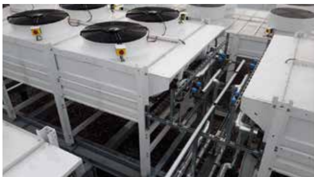
Rys. 2. Chłodnice gazu / parowniki zewnętrzne: chłodnice gazu \text{CO}_2 układów chłodniczych A&B, w połączeniu z zewnętrznymi parownikami odwracalnych pomp ciepła C&D
