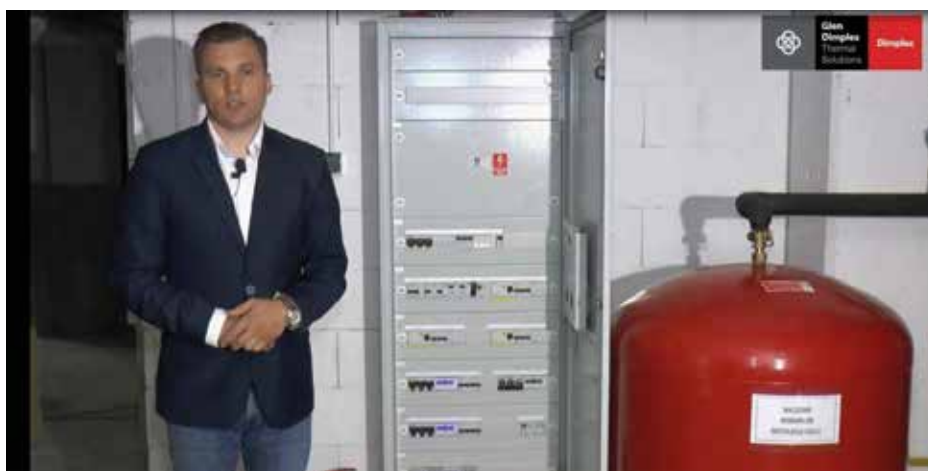
Rys. 4. Widok szafy elektrycznej maszynowni pomp ciepła w obiekcie firmy Elfeko z pełnym opomiarowaniem (źródło: zrzut ekranu z filmu „Dimplex – praca w kaskadzie nie zawsze się opłaca” z kanału YOUTUBE Glen Dimplex Polska)
