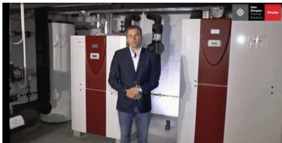
Rys. 2. Maszynownia pomp ciepła w budynku firmy ELFEKO. Po lewej stronie gruntowa pompa ciepła SI 50TU marki Dimplex, natomiast po prawej rewersyjna gruntowa pompa ciepła SI 130TUR+ również marki Dimplex (źródło: zrzut ekranu z filmu „Dimplex – praca w kaskadzie nie zawsze się opłaca” z kanału YOUTUBE Glen Dimplex Polska)
