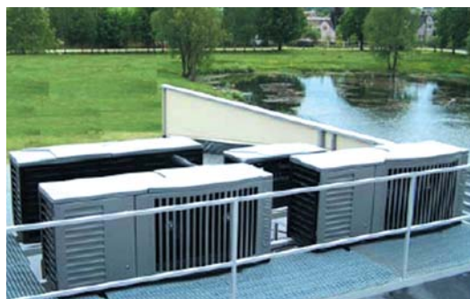
Rys. 5 Sieć trzech agregatów skraplających Copeland EazyCool™ pracujących na Litwie w Wilnie
